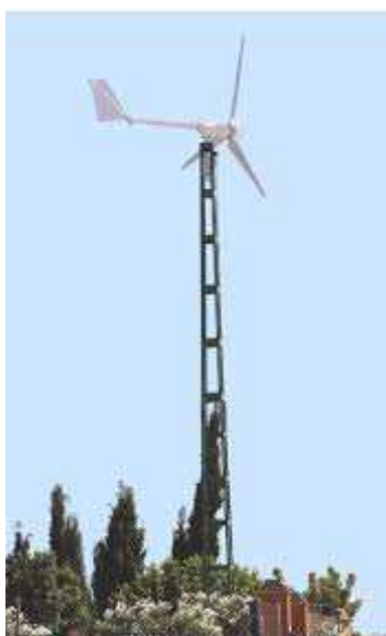
Torre de celosía
